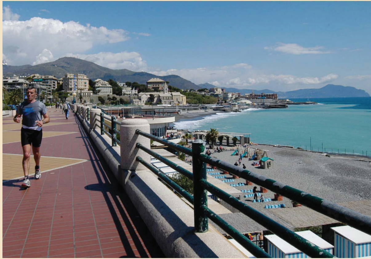
ANCHE LE RINGHIERE di corso Italia si presentano in uno stato di degrado assoluto (FOTO: MACCARINI)
